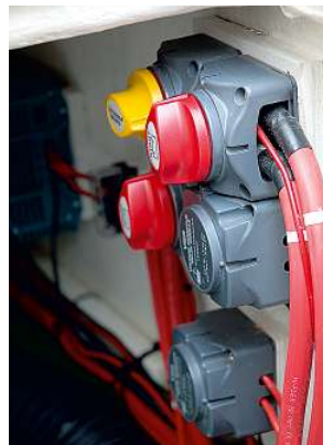
Fachmännisch installiert: Getrennte Batterieschalter
